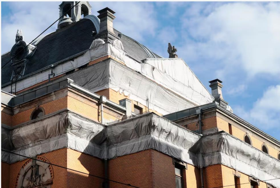
Oslo 20181001. Nationaltheatret forfaller og flere områder inne og ute er dekket til av frykt for at bygningsdeler skal løsne. Flere steder er det tydelige sprekkdannelse. Foto: Lise Åserud / NTB (Foto: Lise Åserud/NTB)
